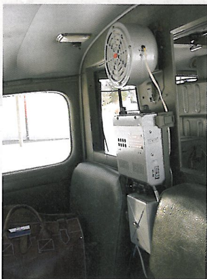
De MT 920 met box en transformator.
